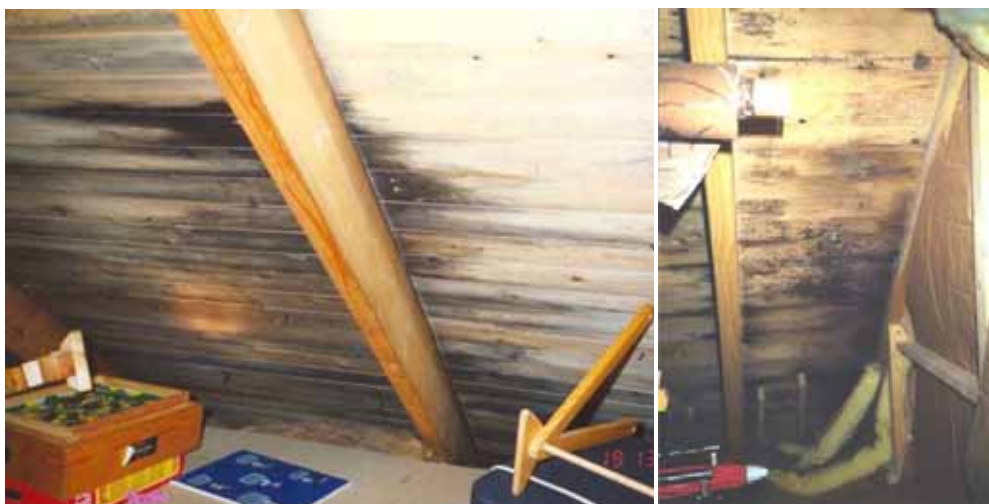
Figur 5 Mögelpåväxt på insidan yttertak.
