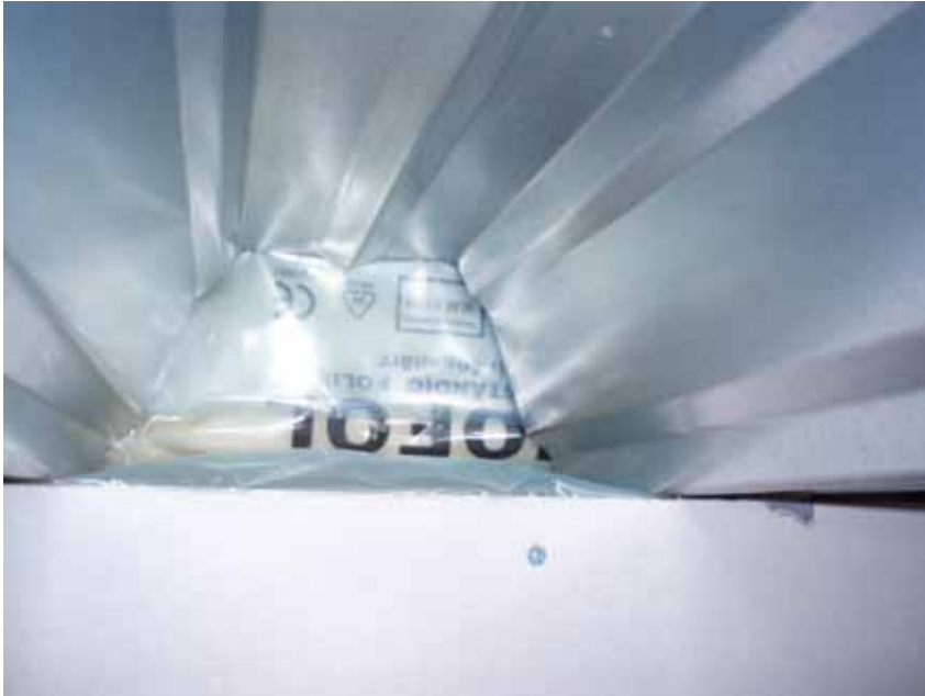
Figur 23 Risk att plastfolien skadas av vass plåt.
