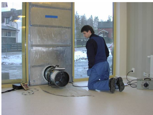
Figur 6 Fläkt monterad i ytterdörr för att skapa tryckskillnad över klimatskalet.
