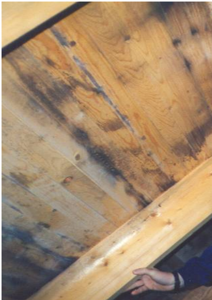
Figur 1 Mögelpåväxt på insida yttertak på grund av fuktkonvektion.
