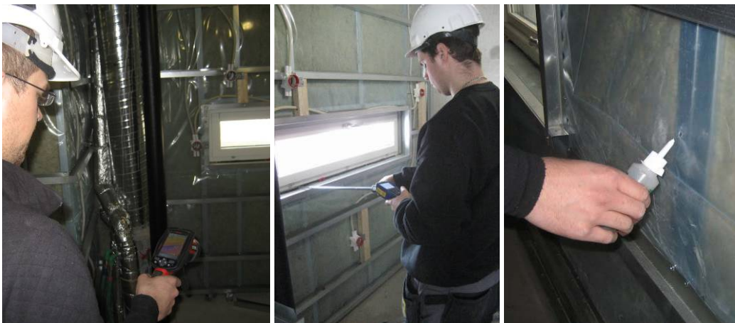
Figur 13 Läckagesökning med värmekamera, lufthastighetsmätare och rökgas.
