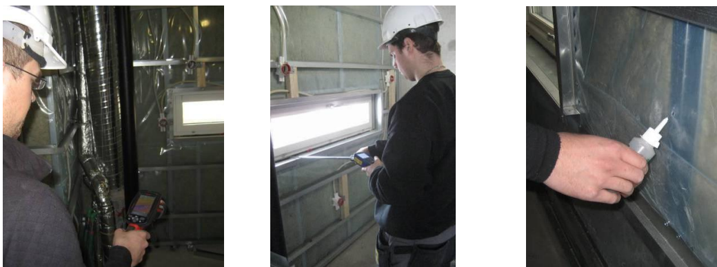
Figur 9 Läckagesökning med värmekamera, lufthastighetsmätare och rökgas.
