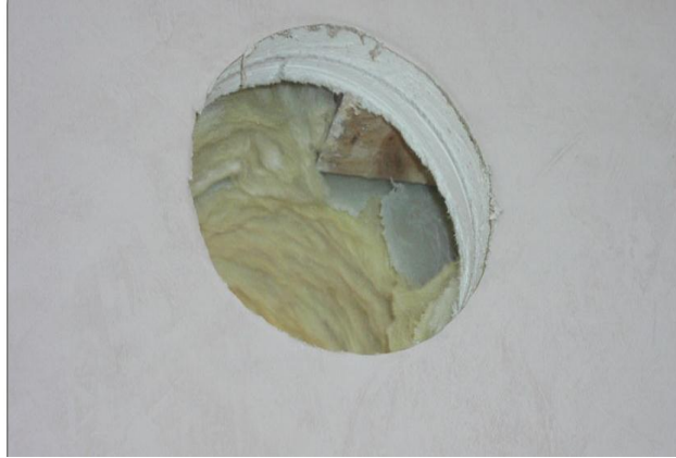
Figur 6 En håltagning i en befintlig konstruktion kan vara svår att få lufttät utan god planering. Foto: Eva Sikander
