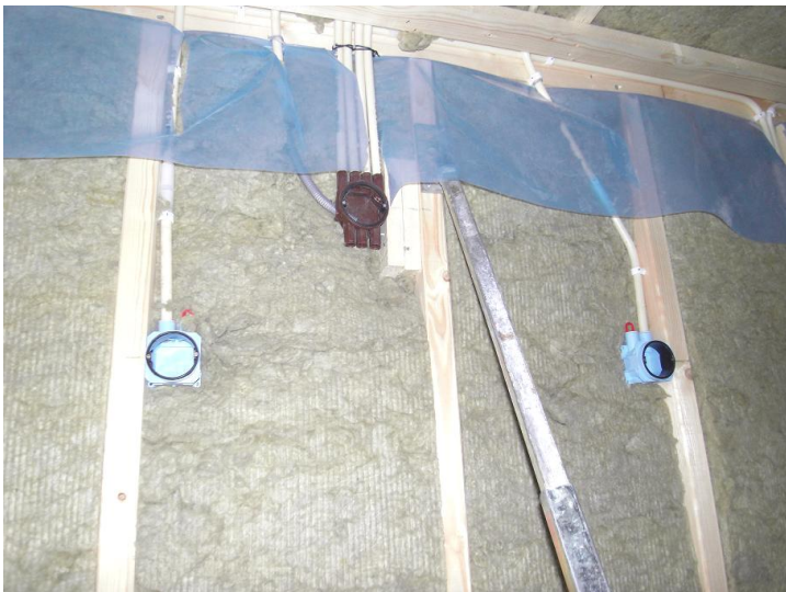
Figur 3 Slarvigt uppskuren plast vid mellanbjälklag
