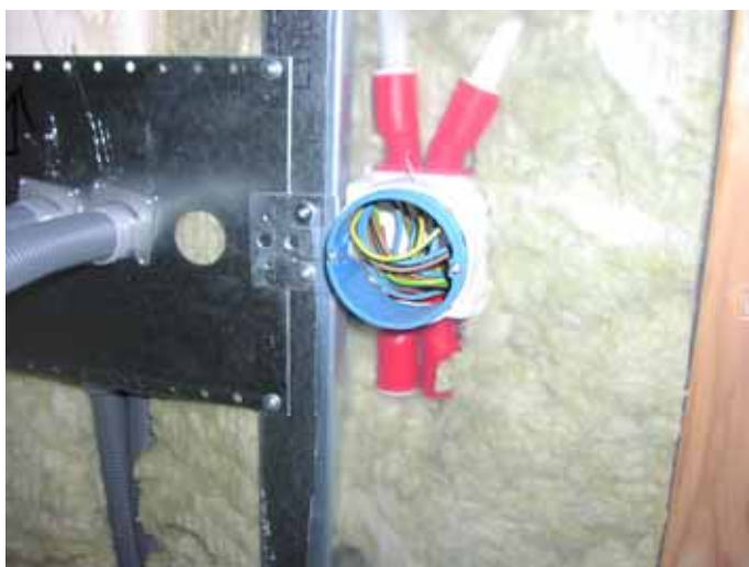
Bild 1 Genomföring av värmerör och eldosa.
