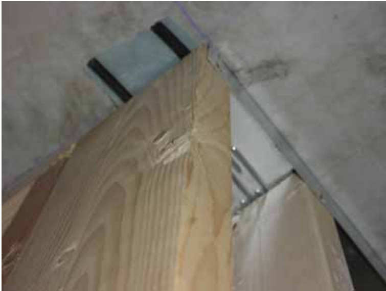
Bild 5 Tåtremsa av S-list mellan hammarband och betongbjälklag.
